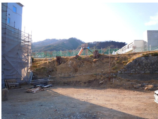
校庭の法面が崩壊した小学校
