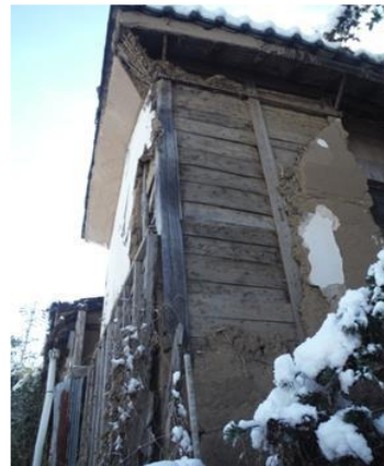
【外壁「大きな剥離等」の例】※
