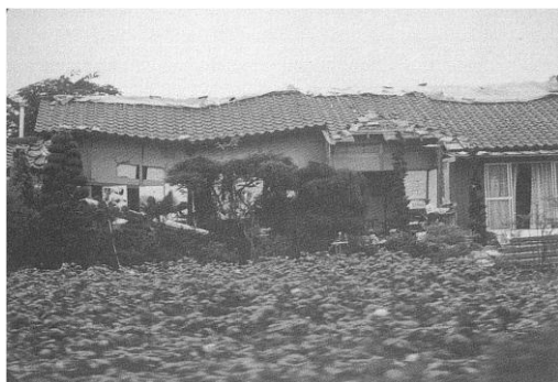
【建築物の不同沈下】※
