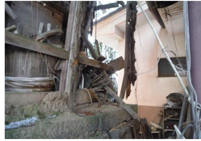
【柱「著しく破損している」の例】※
