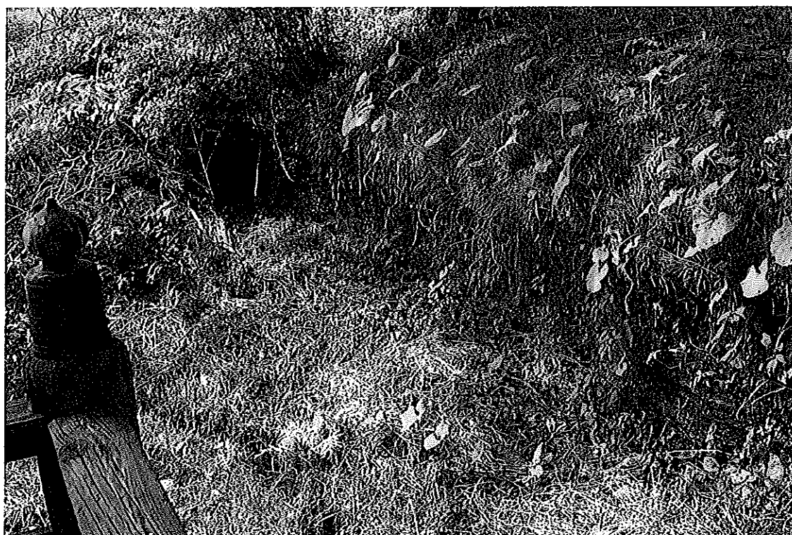
山からの水落の状況 (建物への湿気の影響)
