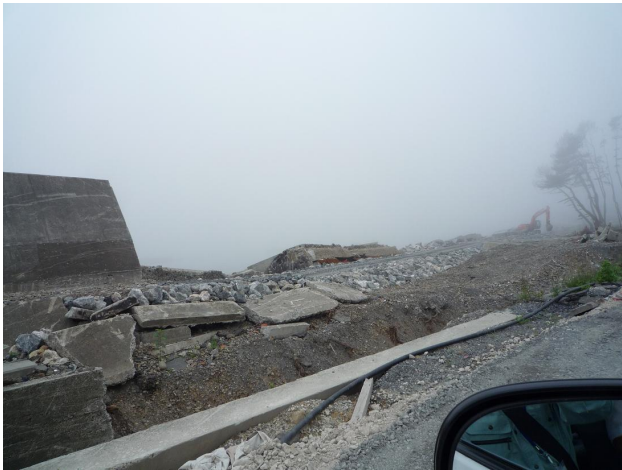
※崩れた防波堤
