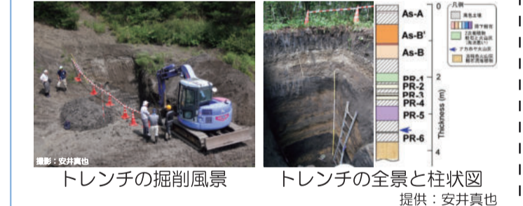
トレンチの掘削風景 トレンチの全景と柱状図 提供:安井貴也
