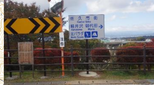
②SIC案内標識設置
