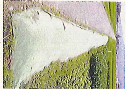
シート内が雑草繁茂により膨らんでいる
