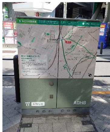
写真 地上機器ラッピングの事例（東京都目黒区）
