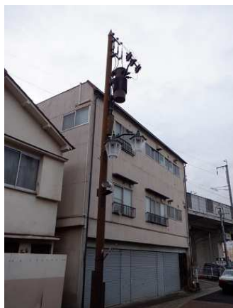
写真 ソフト地中化方式の事例（長野県上田市）
