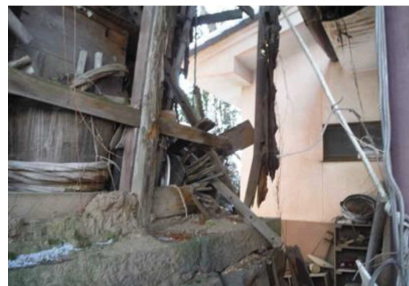
【柱「著しく破損している」の例】※
