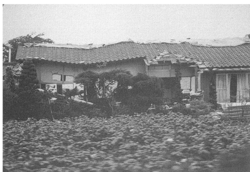
【建築物の不同沈下】※
