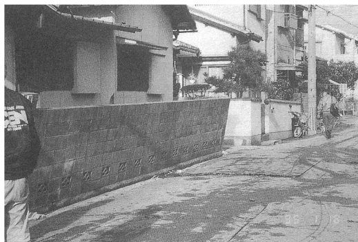
【転倒危険物（ブロック塀）】※
