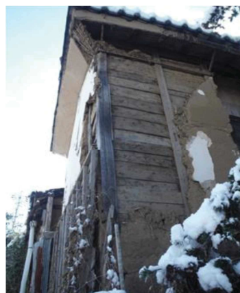
【外壁「大きな剥離等」の例】※
