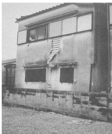
【壁の被害（外壁）】※
