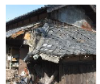
緊急代執行を要する 崩落しかけた屋根
