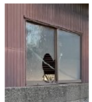
窓が割れた 管理不全空家
