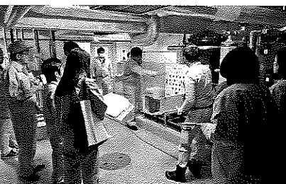
台風災害で浸水したあいとぴあ白田デイサービスセンター地下機械室
