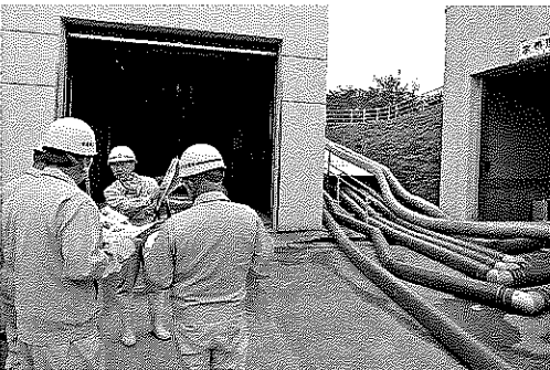
下水道管理センター仮設ポンプの様子
