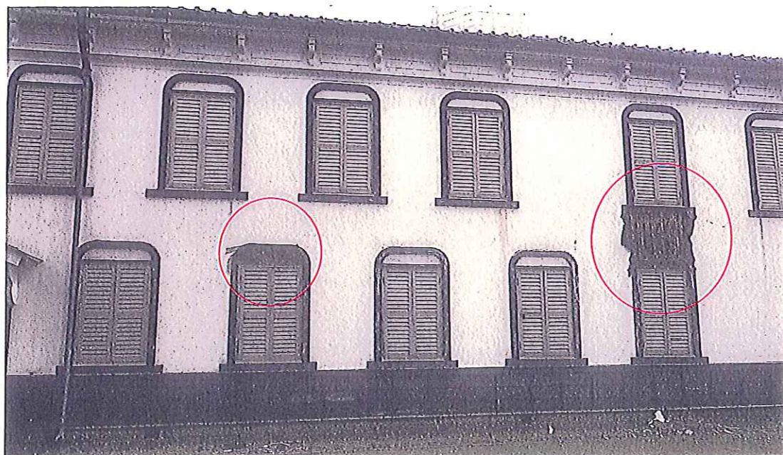
漆喰壁崩落状況
