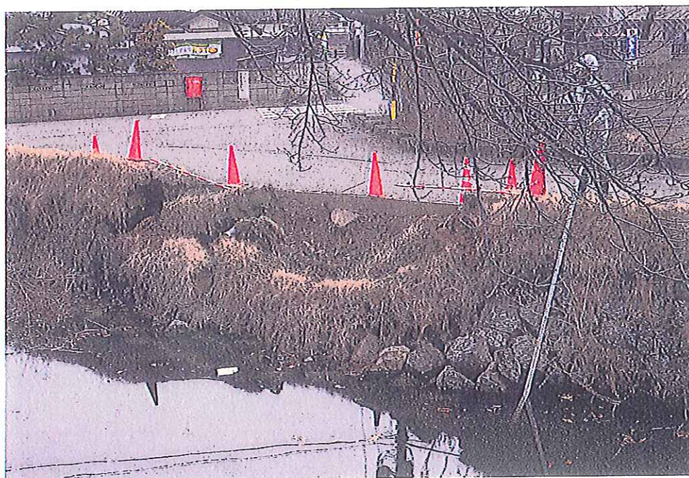
国史跡龍岡城跡 崩落時状況（2013.3.14）
