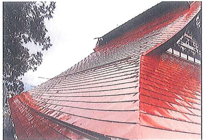
○倉沢薬師堂 指 定:市有形文化財(平成10年4月30日) 所在地:佐久市前山 所有者:貞祥寺 現在の屋根は昭和55年に茅葺にかけたもので、平成7年の塗装後17年が経過しており、錆の発生等が懸念されるため、管理者である前山南区により塗り直しが実施され、佐久市文化財保護事業補助金を交付した。
