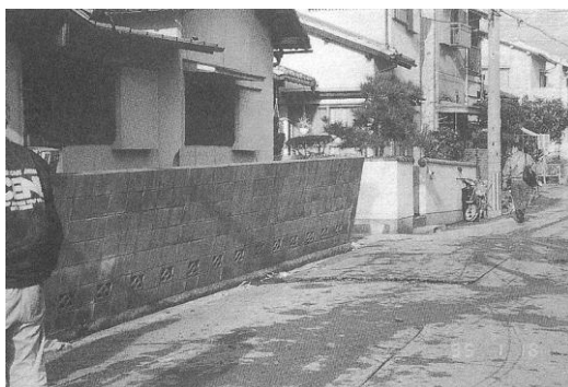
【転倒危険物（ブロック壁）】※
