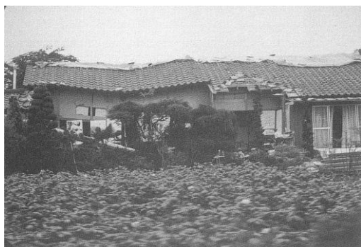
【建築物の不同沈下】※
