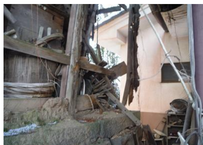
【柱「著しく破損している」の例】※
