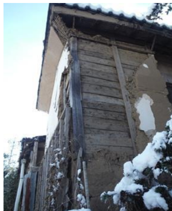
【外壁「大きな剥離等」の例】※
