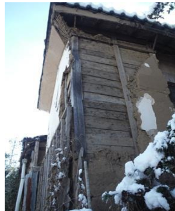
【外壁「大きな剥離等」の例】※
