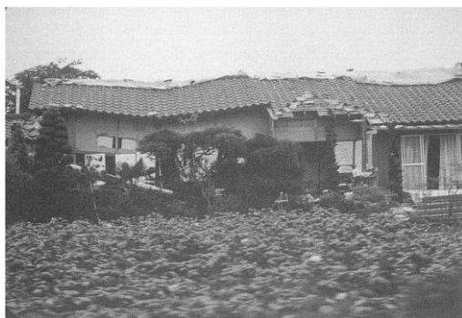
【建築物の不同沈下】※
