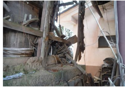
【柱「著しく破損している」の例】※
