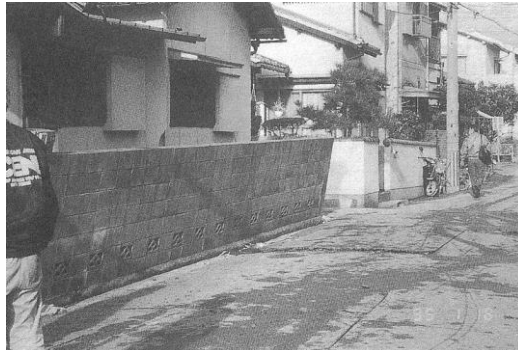
【転倒危険物（ブロック壁）】※
