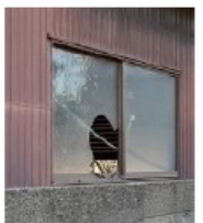
窓が割れた管理不全空家
