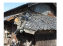
緊急代執行を要する崩落しかけた屋根
