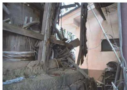
【柱「著しく破損している」の例】※
