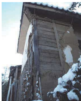
【外壁「大きな剥離等」の例】※
