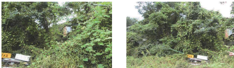
【立木等「繁茂により建物全体が確認できない」例】
