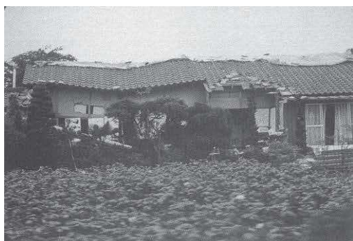
【建築物の不同沈下】※
