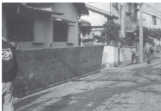
【転倒危険物（ブロック壁）】※
